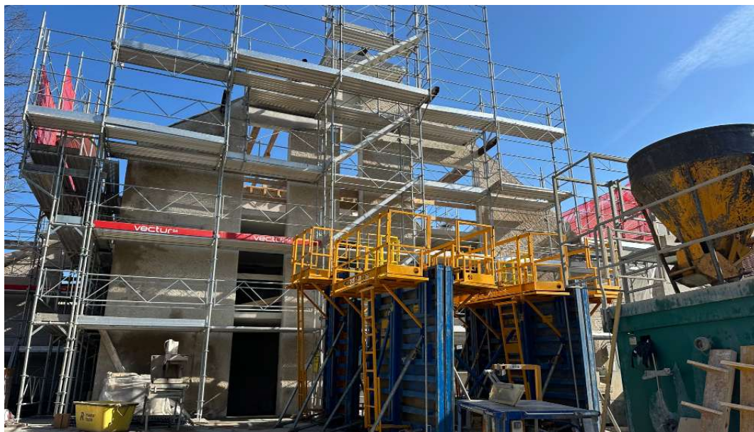
Le chantier de transformation et de rénovation de la Maison du Tilleul a occupé tout 2025.
